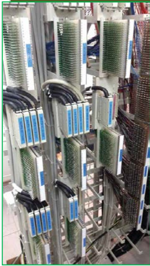
Rame distribuție instalație de centralizare electronică
