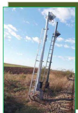
Semnal de avarie instalație BAT
