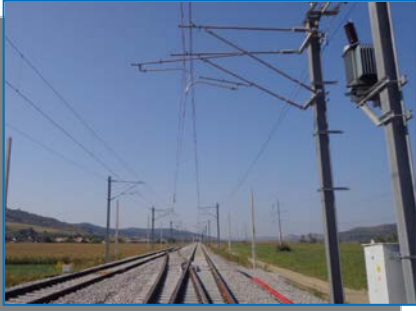
Stația Dumbrăveni - iluminat zonă macazuri
