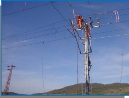
PS Mediaș - echipamente energoalimentare
