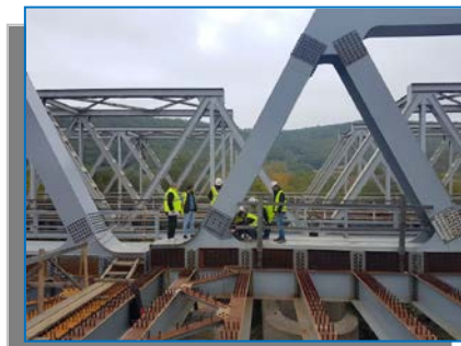
Pod 14 - verificare strângere șuruburi
